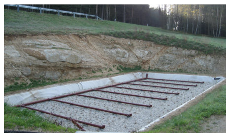
Bodenfilter Kläranlage Schagges
